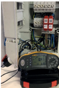
Schleifenimpedanzmessung an einem Unterverteiler mit CEE 16 Adapter, gemessen mit einem Prüfgerät nach DIN EN 61557-3 (VDE0413-3), (herstellerunabhängig einsetzbar)
