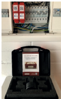
RCD-Prüfadapter im Unterverteiler zur Schleifenimpedanzmessung
